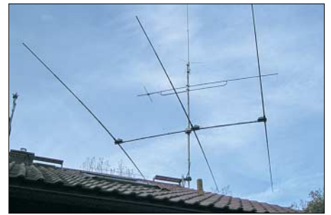
Bild 17: Aufgebaute Antenne 2 m über Dach
